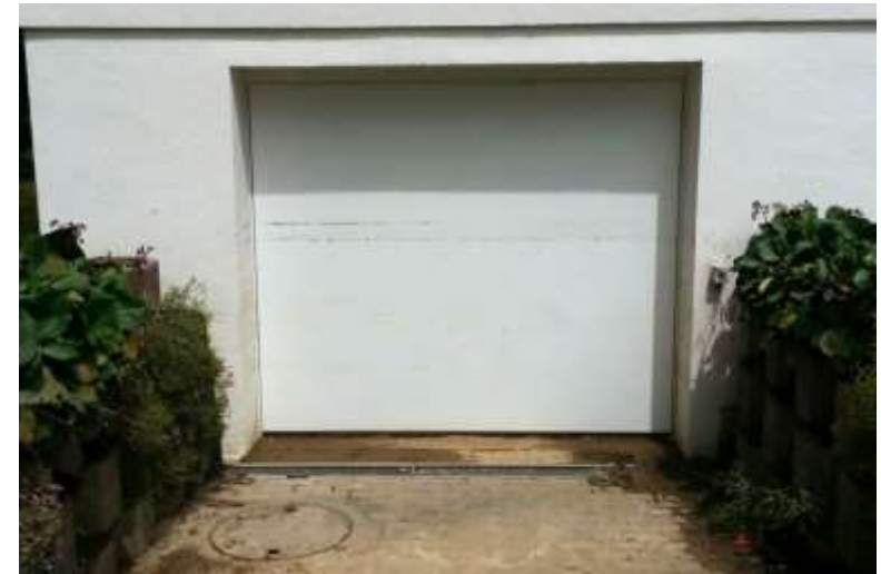
Nach dem Hochwasser
